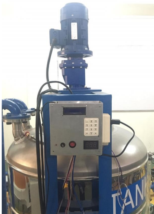
Gambar 4. Hasil Instalasi Alat Pada Mixing Tank
